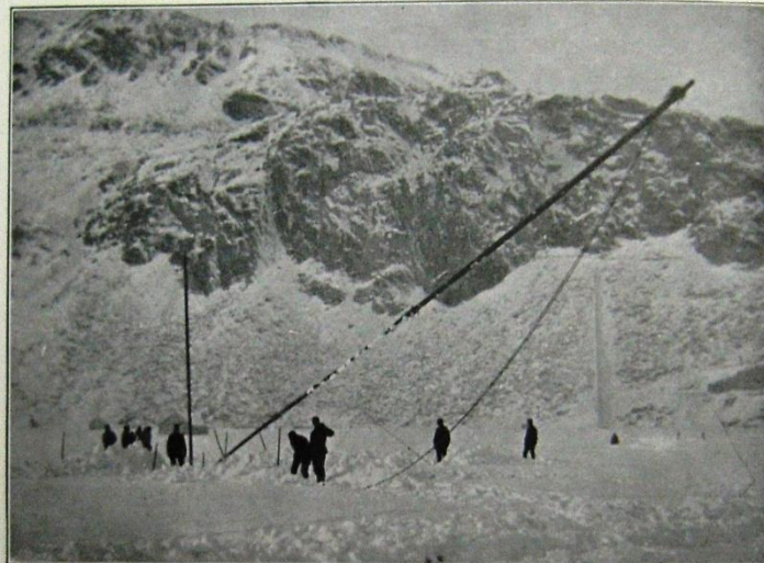
Erection d'un Mât de 21 m. en Suisse, dans des conditions particulièrement difficiles. Novembre 1909
